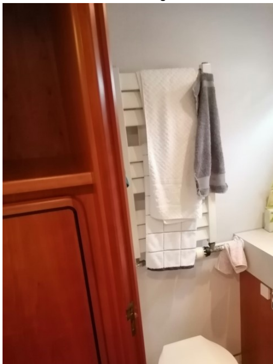
Elektrische Toilette in Achterkabine
